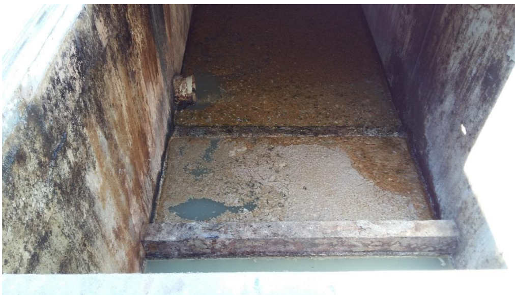
Figura 4.18: Vista interna da Caixa de Gordura da UFEM. Fonte: a autora.
