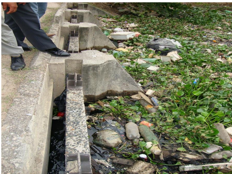
Figura 4.13: Lixo concentrado no gradeamento instalado pelo INEA no Rio Meriti. Fonte: a autora.
