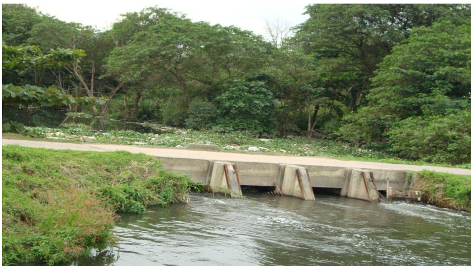
Figura 4.14: Comporta sobre o canal do Rio Meriti e gradeamento parcialmente solto. Fonte: a autora.
