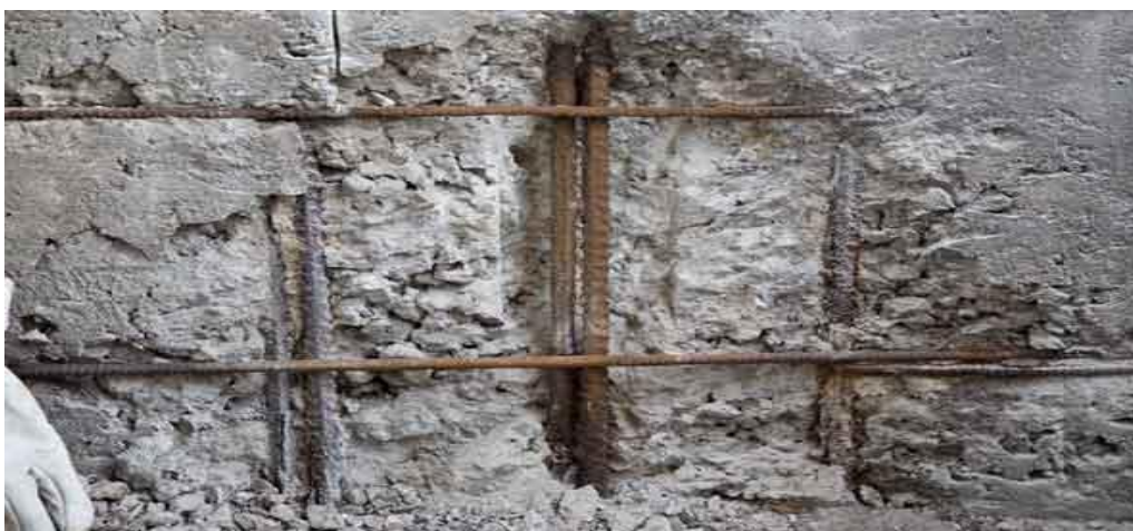
Figura 2.5: Área de superfície com recobrimento insuficiente e mal executado. Fonte: a autora.
