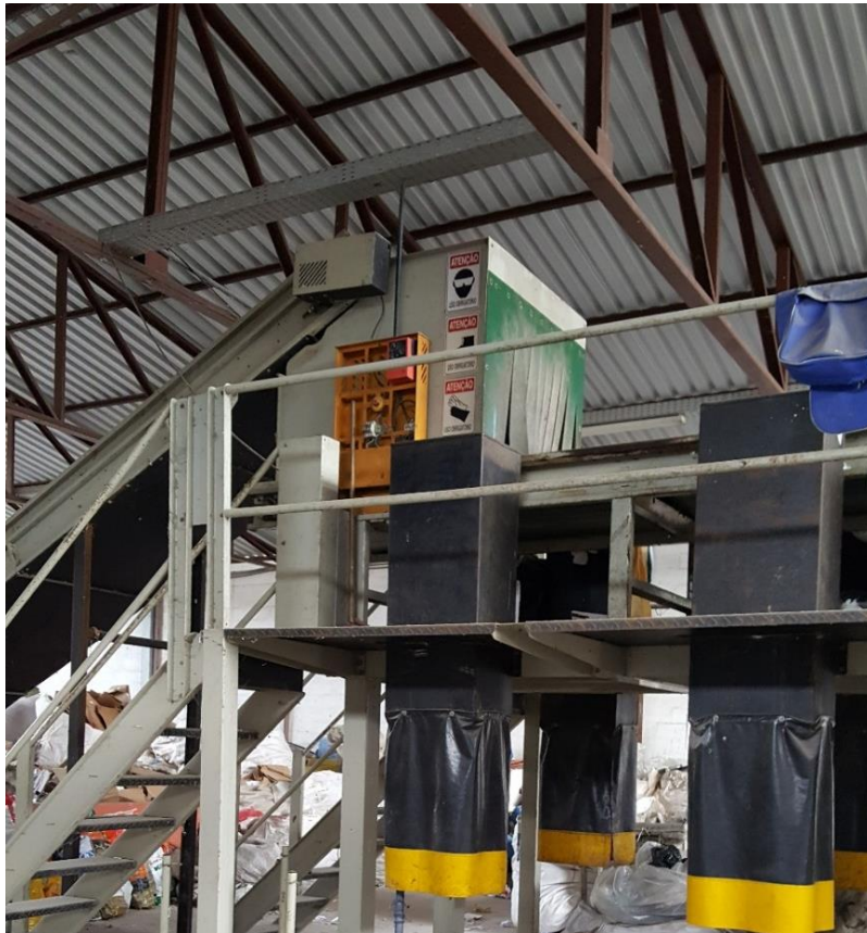
Foto 10: Maquinário com esteira para separação de materiais sem utilização adequada por falta de energia elétrica. Fonte: Próprio autor.
