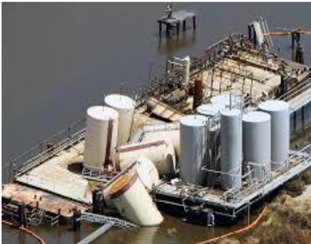
Figura 8: Área de armazenamento de petróleo danificada na costa no Golfo do México. Fonte: (BBC, 2016.)
