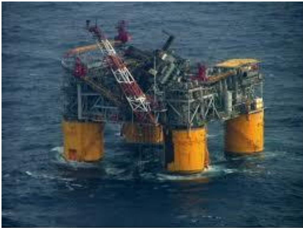
Figura 7: Plataforma danificada pelo furacão Katrina. Fonte: (BBC, 2016.)
