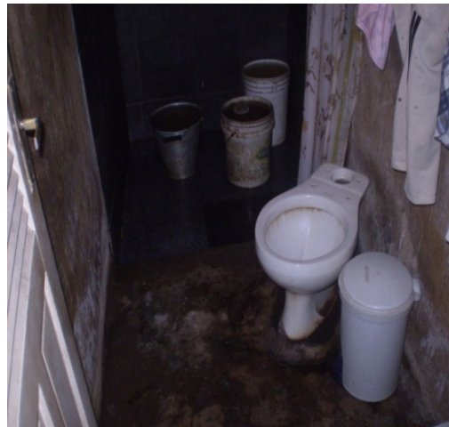
Foto 36 – Banheiro sem água encanada ou chuveiro. (Antes) Ano: 2010.
