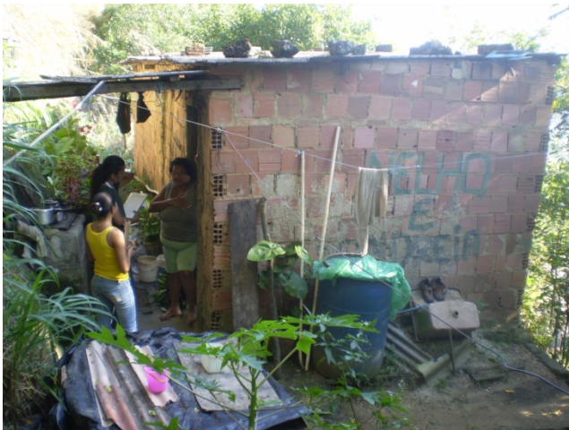
Foto 35 – Situação da residência em área de risco. (Antes) Ano: 2010.
