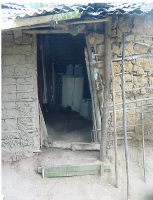
Foto 31 – Residência de pau a pique com problemas estruturais. (Antes). Ano: 2010.
