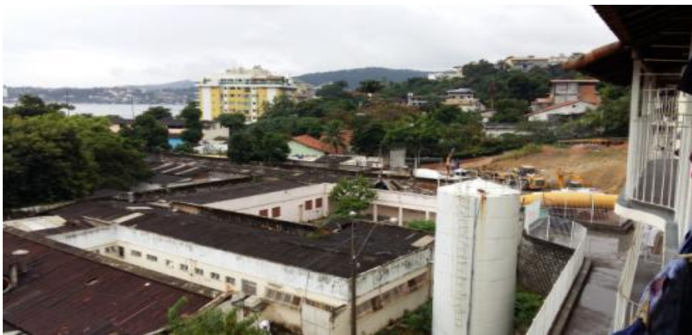
Foto 22 – Vista do PAC III para o avanço das obras da Transoceânica no túnel Charitas-Cafubá e parte do Hospital Psiquiátrico que será desapropriado. Fonte: Acervo pessoal 18/05/2016.
