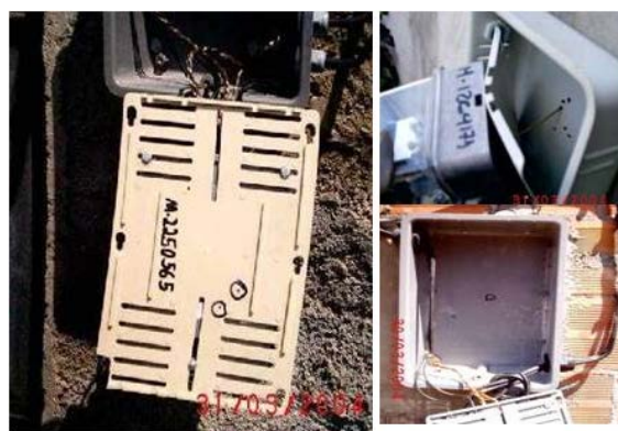
Foto 09 – Medidores furados. Ano: 2004.
