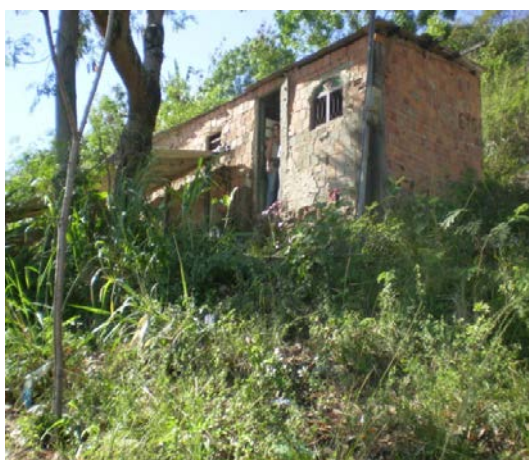
Foto 27 – Isolamento da residência localizada em área de risco.
