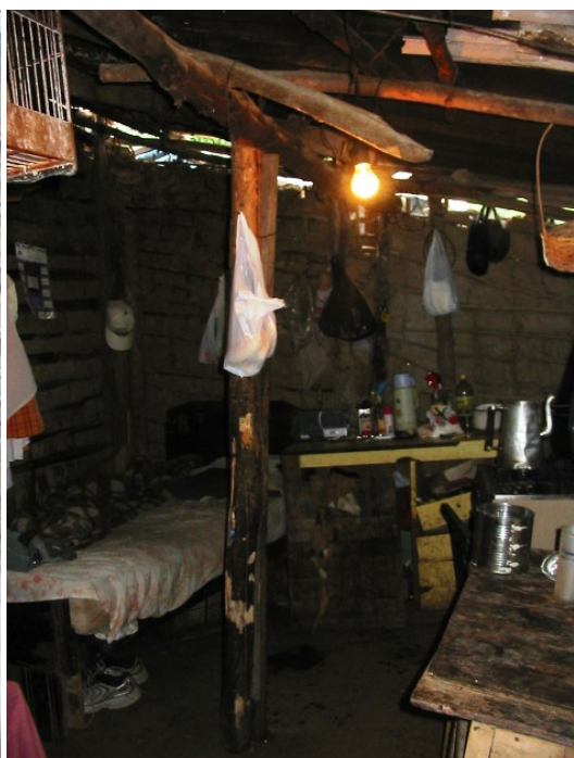
Foto 32 – Graves problemas estruturais na residência (precária instalação elétrica, ausência de divisão entre cômodos e água encanada). (Antes) Ano: 2010.
