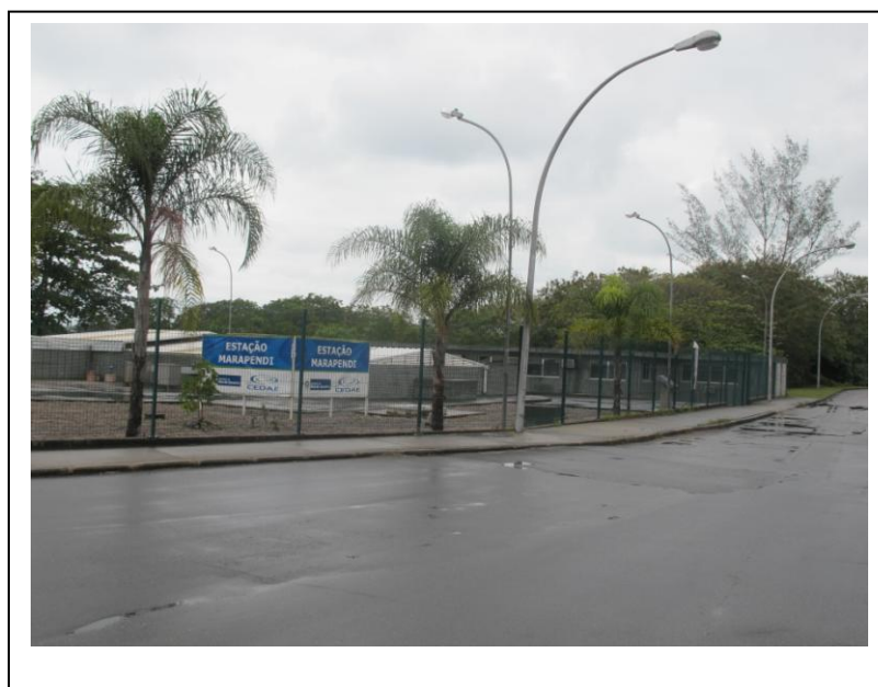
Figura 26 – Elevatória Marapendi (atrás do Condomínio Park Palace) – Rio de Janeiro / RJ
