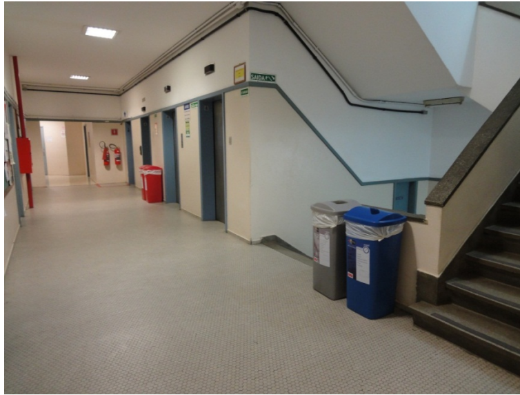
Figura 199 – Coletores seletivos no 4º pavimento da Ala Frings - Edifício Amizade
