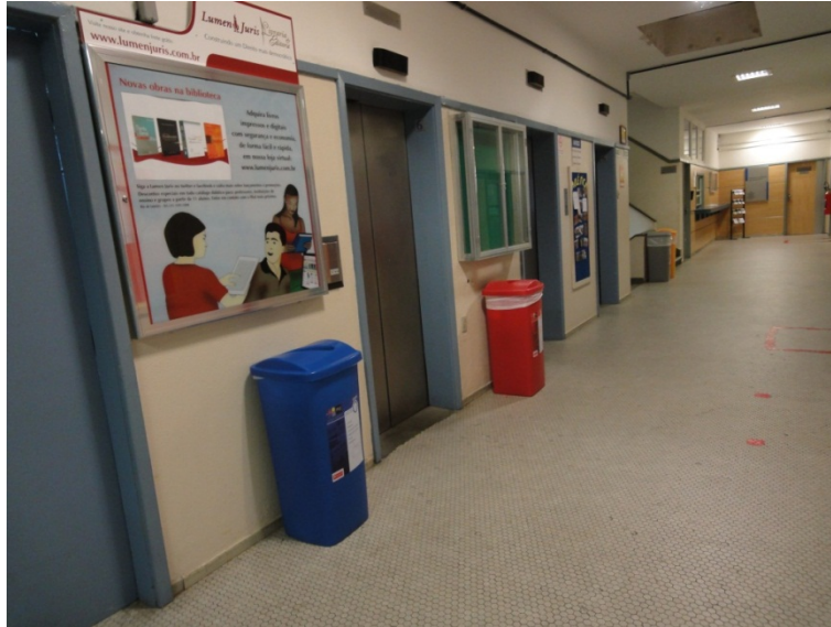
Figura 212 – Coletores seletivos no 6º pavimento da Ala Frings - Edifício Amizade
