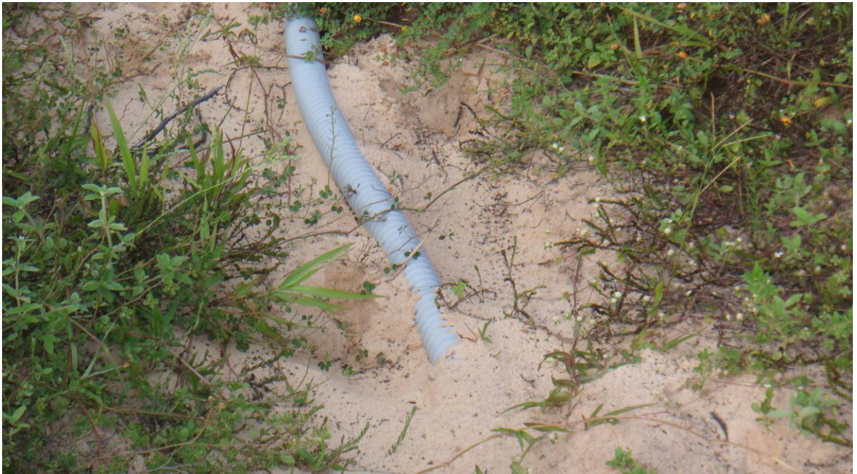
Figura 17: Eletricidade com acesso errado na Usina Eólica Prainha (CE)
