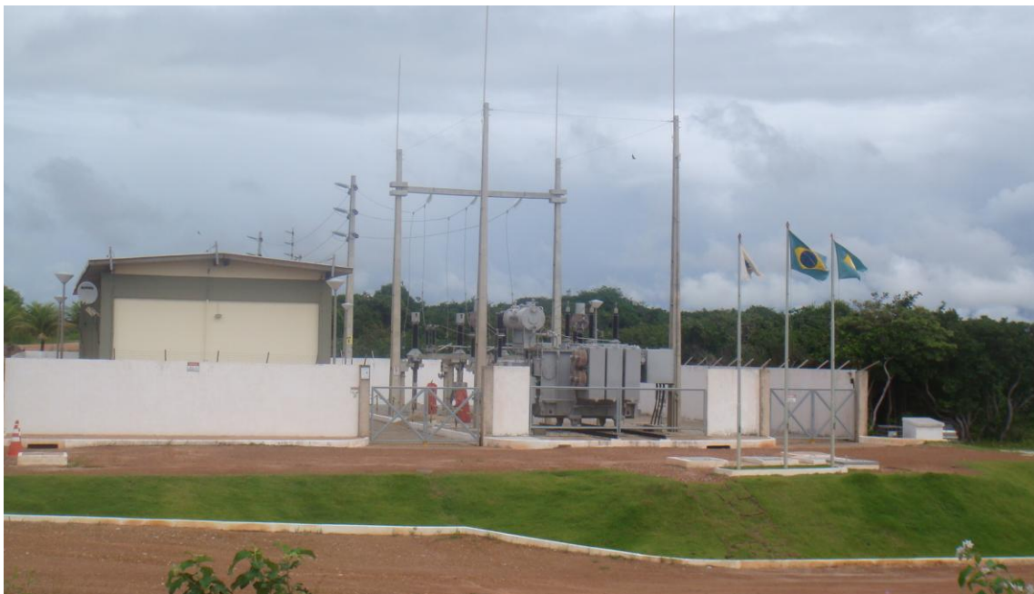
Figura 15: Central Elétrica da Empresa Bons Ventos no Porto do Pecém – Ceará
