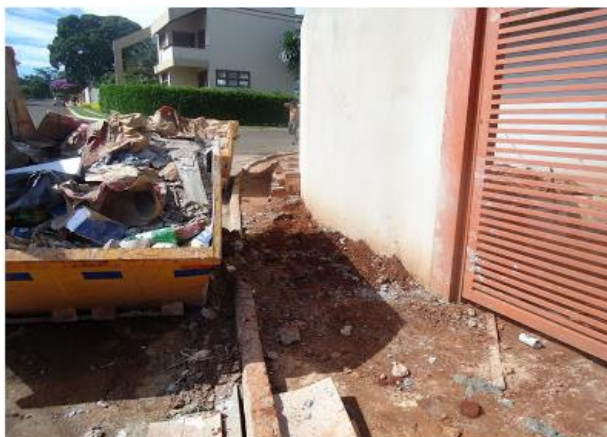
Figura 17 – Calçada sem possibilidade de circulação, com a obra não sinalizada, não possuindo uma rampa provisória para desvio pelo asfalto. Fonte: Blog Acessibilidadenaprática. (2011)
