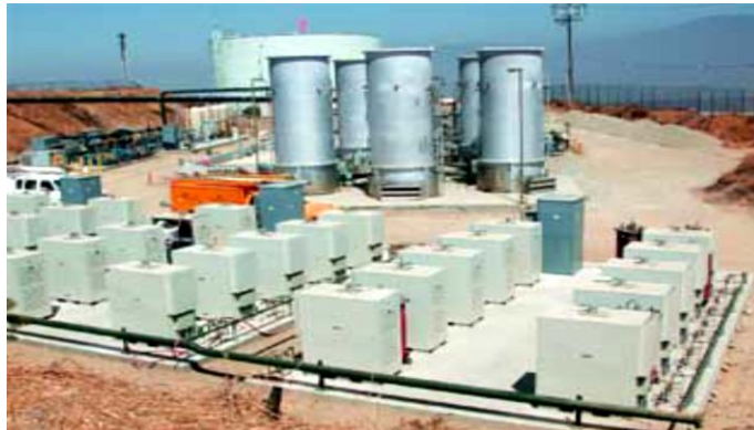
Figura 54 – Instalações com microturbinas em aterros. Fonte: Godlove, 2010.
