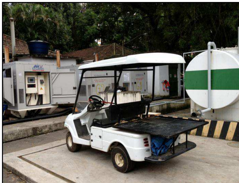
Figura 12: Gerador de energia elétrica movido a óleo diesel.
