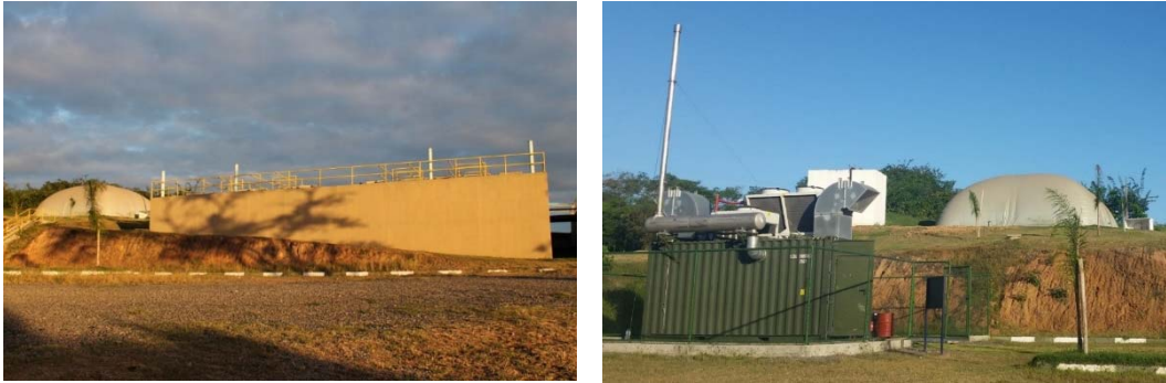
Figura 27 (a) - Digestores Anaeróbios de Fluxo Ascendente – DAFA da ETE Jacuípe II em Feira de Santana – BA.
