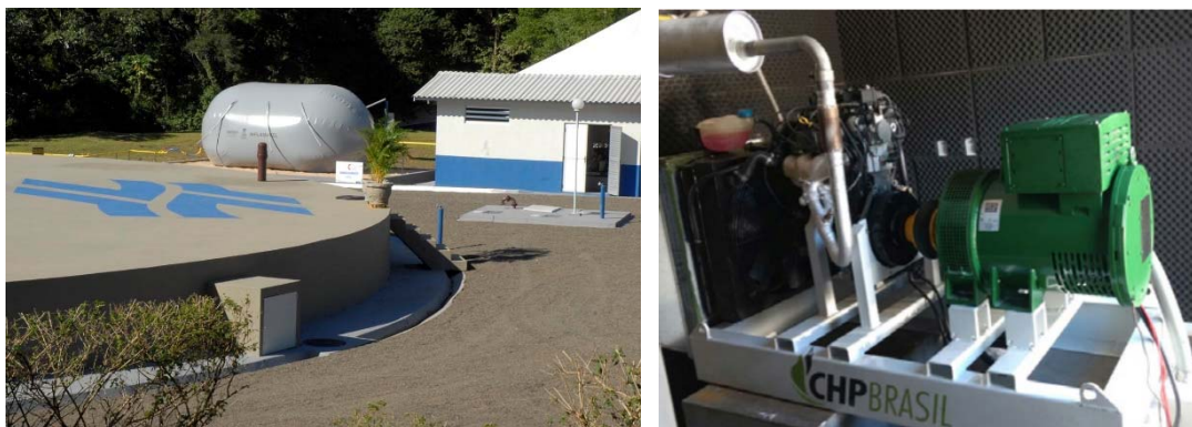
Figura 26 (a) - Reator anaeróbio seguido pelo gasômetro e o motogerador (dentro da casa).
