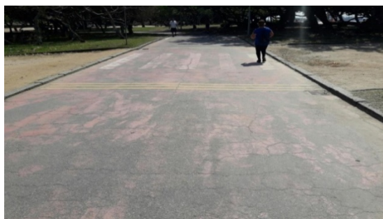
Figura 30: Estado deteriorado da sinalização e faixa de pedestres no trecho 2. Fonte: Autoria própria.
