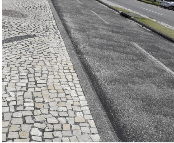
Figura 31: Má conservação do asfalto no trecho 5. Fonte: Autoria própria.
