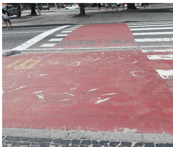
Figura 27: Conservação da pintura da sinalização horizontal no trecho 1. Fonte: Autoria própria.
