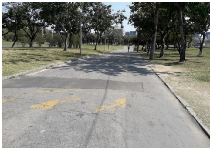
Figura 19: Trafficcalming em local apropriado com sinalização horizontal falha.
