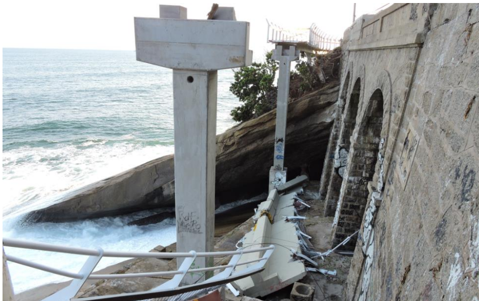
Figura 2 - Ciclovia Tim Maia, Rio de Janeiro-RJ após queda de um dos tabuleiros devido à força ascendente de ondas do mar.
