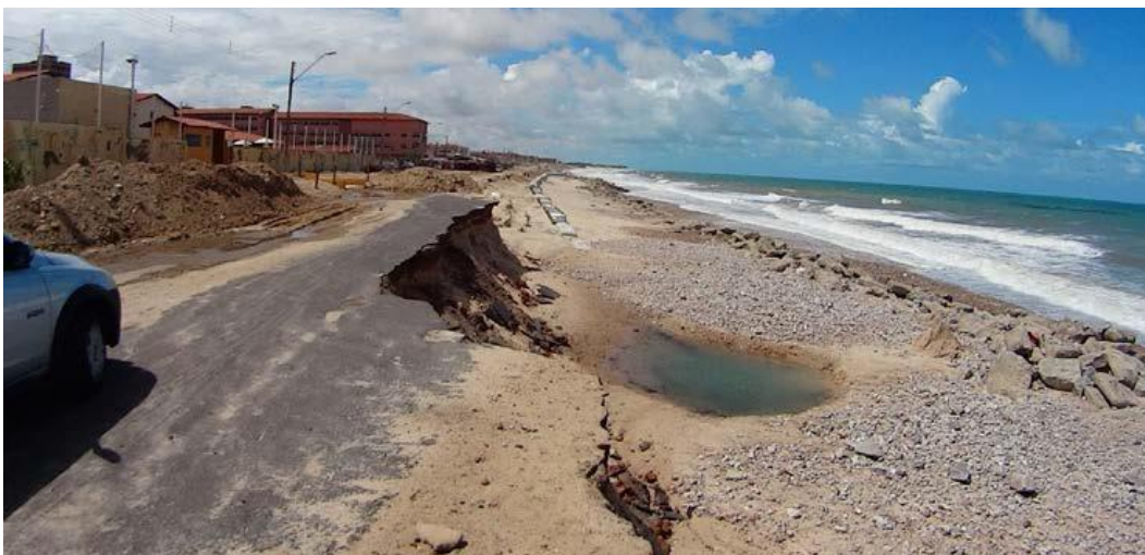
Figura 1 - Avenida Litorânea na praia do Icaraí, Município de Caucaia – CE. O processo erosivo continua mesmo após a obra do bagwall .
