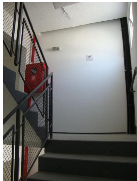
Figura 2.15 – Sistema de contra incêndio e iluminação de emergência.
