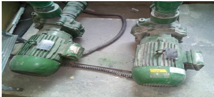
Foto 5 - Bombas – Park Riviera da Costa
