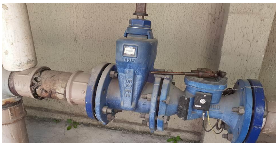
Foto 3 - Entrada de água da concessionária – Park Riviera da Costa
