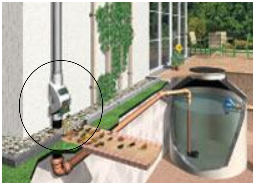
Figura 14 - Filtro na tubulação de água de chuva.
