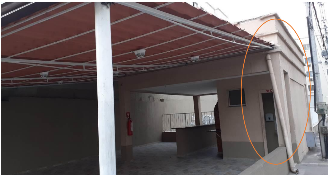
Foto 11 - Área da churrasqueira/drenagem – Park Riviera da Costa.
