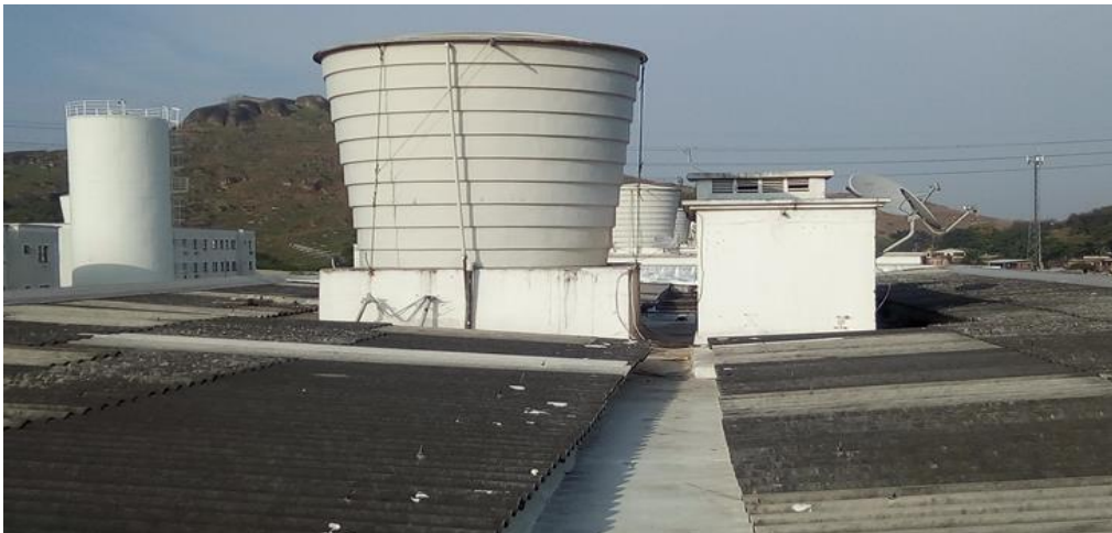
Foto 7 - Reservatório, calha e telhado – Park Riviera da Costa.
