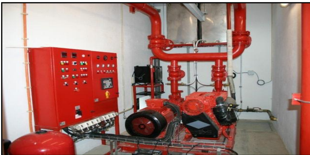
Figura 9: Central de Equipamento de Incêndio. Fonte: Pitêu, J.V.T. (2011).
