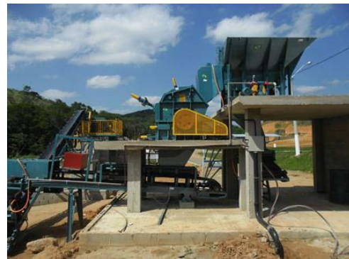
Vista geral da esteira que recebe do britador, em vermelho oimã. Fonte: Consórcio N/I. Relatório nov/2012.
