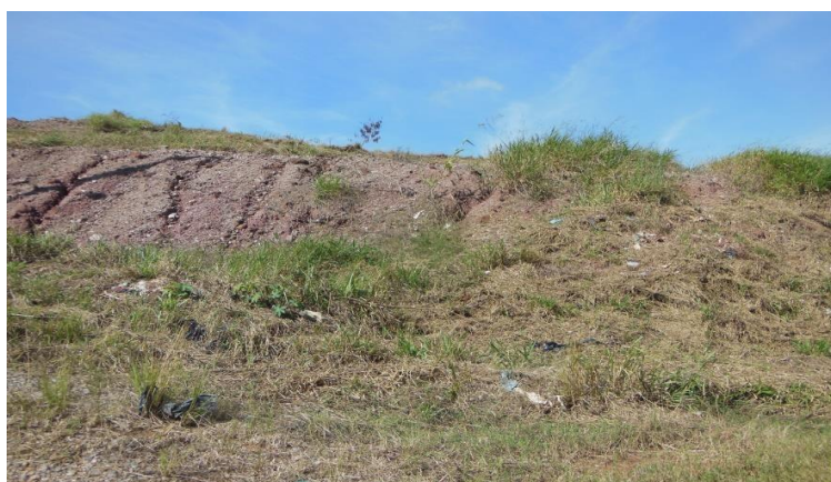
Figura 27 – Imagem do talude com a presença de resíduos (vistoria realizada em maio de 2016). Fonte: Próprio autor.
