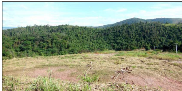
Figura 37 - Imagem do talude no ponto mais alto do vazadouro (vistoria em maio de 2016). Fonte: Próprio autor.
