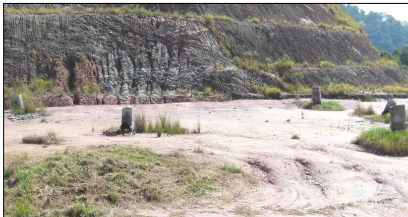
Figura 31 – Drenos verticais para gases (vistoria em maio de 2016).
