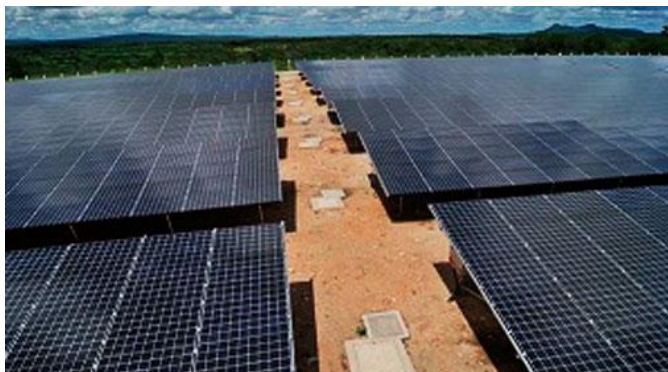
Foto 2 - Usina Fotovoltaica de Tauá (CE). Fonte: ENEVA (2016).
