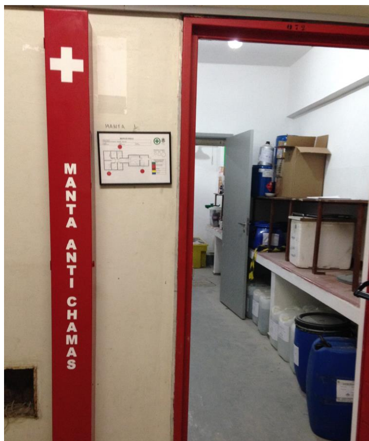
Figura 20: Central de armazenamento de resíduos Classe I do Departamento de Química
