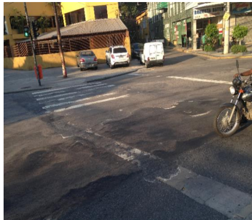
Figura 1.4 – Sinalização deficiente Fonte: Autoria própria
