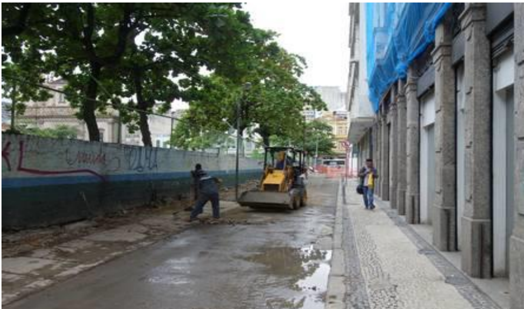
Foto 2 – Foto da travessa Belas Artes durante as obras de revitalização. Fonte: Macedo, Aline. Travessa Belas Artes, no Centro do Rio, ganha reurbanização. Jornal Extra, 2018. Coluna Berenice Seara.
