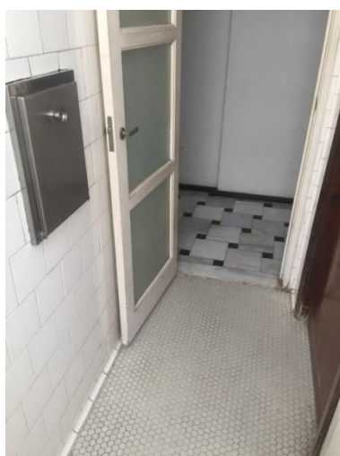
Figura 24: Edifício Paraíso – Local de instalação do tubo de queda nos pavimentos e ausência de compartimento de coleta.
