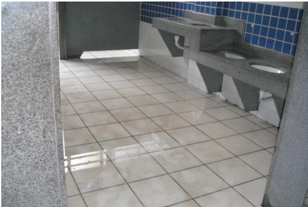
Foto 8- Banheiro totalmente alagado na escola A. Fonte: Registro da pesquisadora, 2017.
