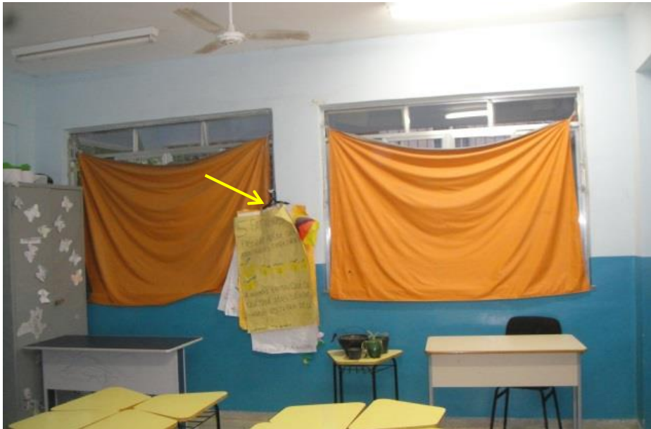
Foto 10- Utilização inadequada de alavanca da bascula de janela, escola B Fonte: Registro da pesquisadora, 2017.
