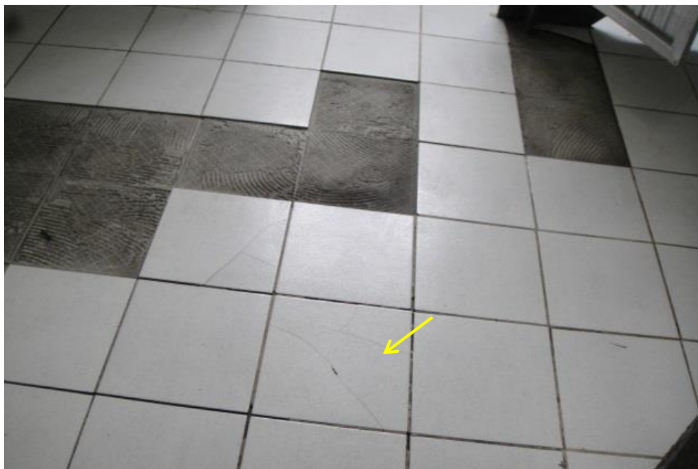
Foto 13- Piso com trinca em um dos banheiros da escola A
