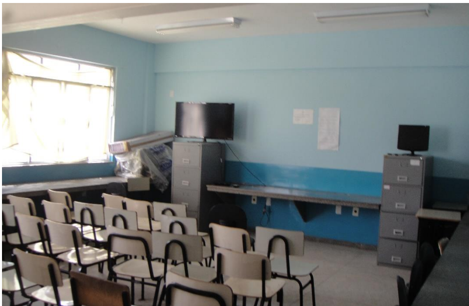
Foto 11- Utilização inadequada de alavanca da bascula de janela, escola A. Fonte: Registro da pesquisadora, 2017.
