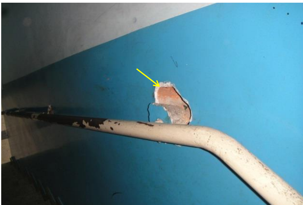
Foto 5- Corrimão da escada da escola A solto. Fonte: Registro da pesquisadora, 2017.
