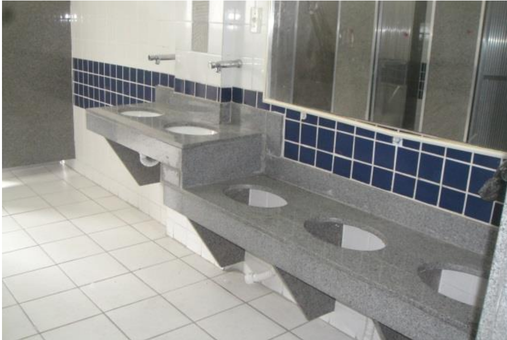
Foto 14- Falta de cuba por desprendimento, nos banheiros da escola A. Fonte: Registro da pesquisadora, 2017.
