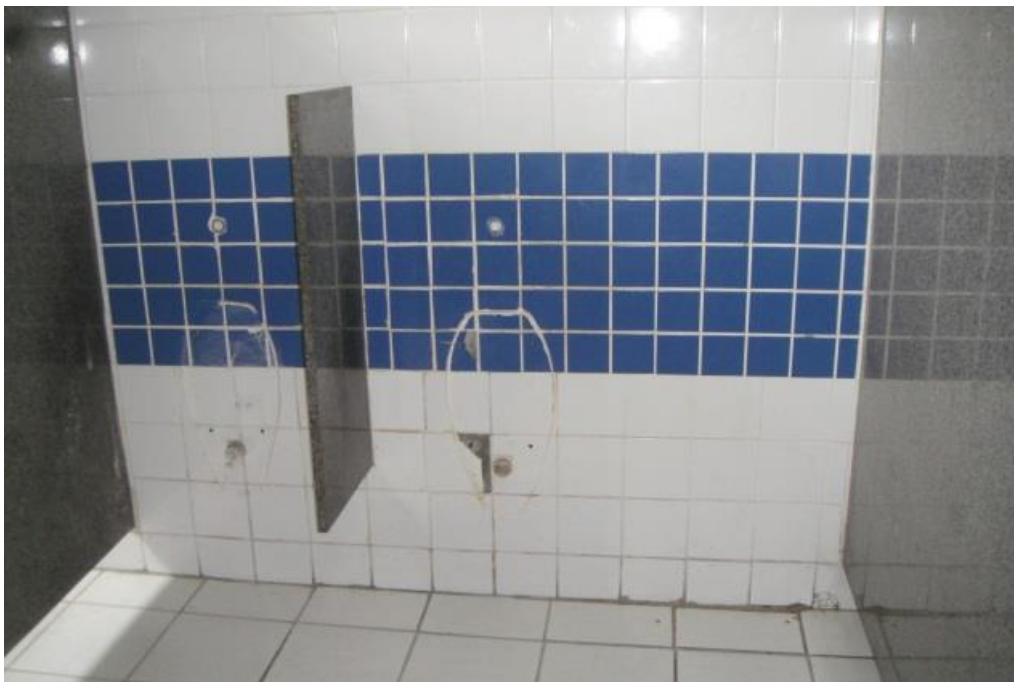
Foto 15- Falta de mictório no banheiro da escola A. Fonte: Registro da pesquisadora, 2017.
